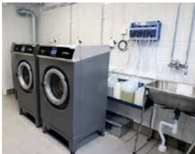
Pump-o-tronic kan styra upp till 4 pumpar för automatisk dosering av olika tvättmedel och andra tillsatser.
